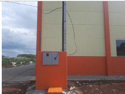
FOTO 19 ITEM 8.57: ENTRADA DE ENERGIA ELÉTRICA, SUBTERRÂNEA, TRIFÁSICA, COM CAIXA DE SOBREPOR TIPO GNE, CABO DE 25 MM2 E DISJUNTOR DIN 200A MEDIDO: 100%
