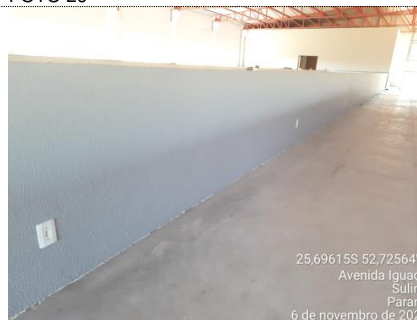
FOTO 28 ITEM 8.19: CAIXA RETANGULAR 4" X 2" BAIXA (0,30 M DO PISO), PVC, INSTALADA EM PAREDE - FORNECIMENTO E INSTALAÇÃO. AF_12/2015 MEDIDO: 100%
