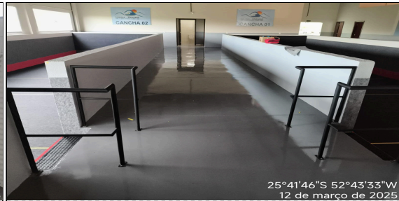
25°41'46"S 52°43'33"W 12 de março de 2025 5 | GUARDA-CORPO DE AÇO GALVANIZADO DE 1,10M DE ALTURA, MONTANTES TUBULARES DE 1.1/2" ESPAÇADOS DE 1,20M, TRAVESSA SUPERIOR DE 2", GRADIL FORMADO
