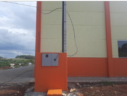
FOTO 19 ITEM 8.57: ENTRADA DE ENERGIA ELÉTRICA, SUBTERRÂNEA, TRIFÁSICA, COM CAIXA DE SOBREPOR TIPO GNE, CABO DE 25 MM 2 E DISJUNTOR DIN 200A MEDIDO: 100%
