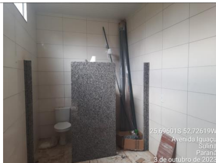
FOTO 11 ITEM 9.61: CHUVEIRO ELÉTRICO COMUM CORPO PLÁSTICO, TIPO DUCHA – FORNECIMENTO E INSTALAÇÃO. AF_01/2020 MEDIDO: 100%
