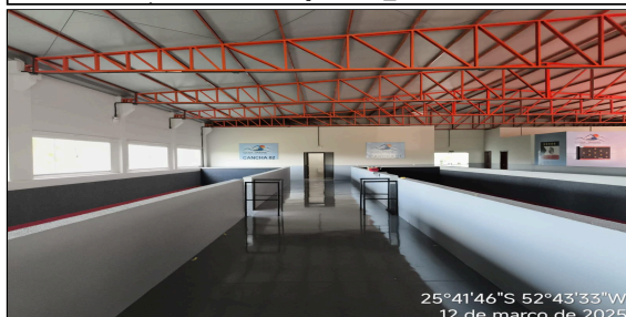
25°41'46"S 52°43'33"W 12 de março de 2025 10 | 8.40 LUMINÁRIA DE EMERGÊNCIA, COM 30 LÂMPADAS LED DE 2 W, SEM REATOR - FORNECIMENTO E INSTALAÇÃO. AF_02/2020
