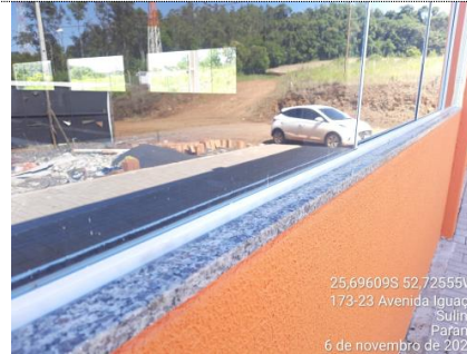
FOTO 24 ITEM 7.15: JANELA DE ALUMÍNIO DE CORRER COM 4 FOLHAS PARA VIDROS, COM VIDROS, BATENTE, ACABAMENTO COM ACETATO OU BRILHANTE E FERRAGENS. EXCLUSIVE ALIZAR E CONTRAMARCO. FORNECIMENTO E INSTALAÇÃO. AF_12/2019 MEDIDO: 50%
