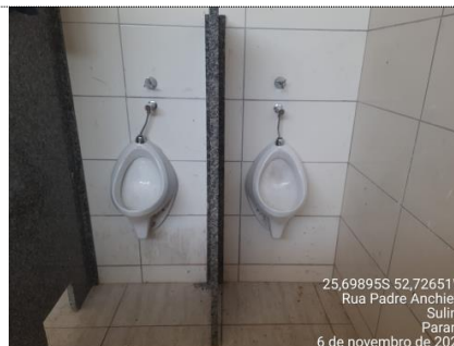
ITEM 9.56: MICTÓRIO SIFONADO LOUÇA BRANCA – PADRÃO MÉDIO – FORNECIMENTO E INSTALAÇÃO. AF_01/2020 MEDIDO: 100%
