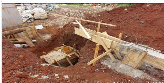
6 | Lateral direita: necessário instalar pilares pré-moldados para dar continuidade à viga baldrame
