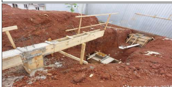
8 | Lateral esquerda: necessário instalar pilares pré-moldados para dar continuidade à viga baldrame
