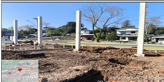
7 | SERVIÇO EXECUTADO ESCAVAÇÃO MECANIZADA DE VALA COM PROF. ATÉ 1,5 M (MÉDIA MONTANTE E JUSANTE/UMA COMPOSIÇÃO POR TRECHO), ESCAVADEIRA
