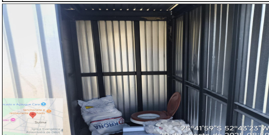
5 | SERVIÇO EXECUTADO EXECUÇÃO DE SANITÁRIO E VESTIÁRIO EM CANTEIRO DE OBRA EM CHAPA DE MADEIRA COMPENSADA, NÃO INCLUSO MOBILIÁRIO. AF_02/2016
