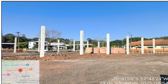
9 | SERVIÇO EXECUTADO PILAR PRÉ-FABRICADO EM CONCRETO ARMADO DE SEÇÃO 0.35X0.35X6,50MT, FORNECIMENTO E INSTALAÇÃO
