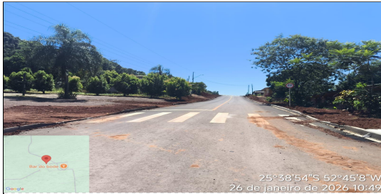
25°38'54"S 52°45'8"W 26 de janeiro de 2026 10:49 7 | RUA SEDE OURO 04 - SERVIÇO EXECUTADO DE TERRAPLENAGEM, DRENAGEM, BASE/SUB BASE, REVESTIMENTO, MEIO FIO, SERVIÇO DE URBANIZAÇÃO,
