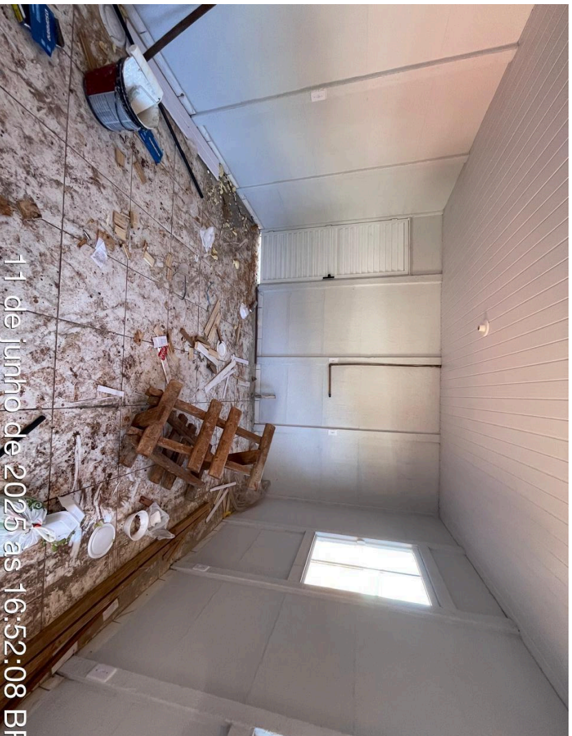
Foto 02 – Paredes e portas de madeira pintadas; Portas e janelas de alumínio instaladas; acabamentos de elétrica concluídos; (Local 01)
