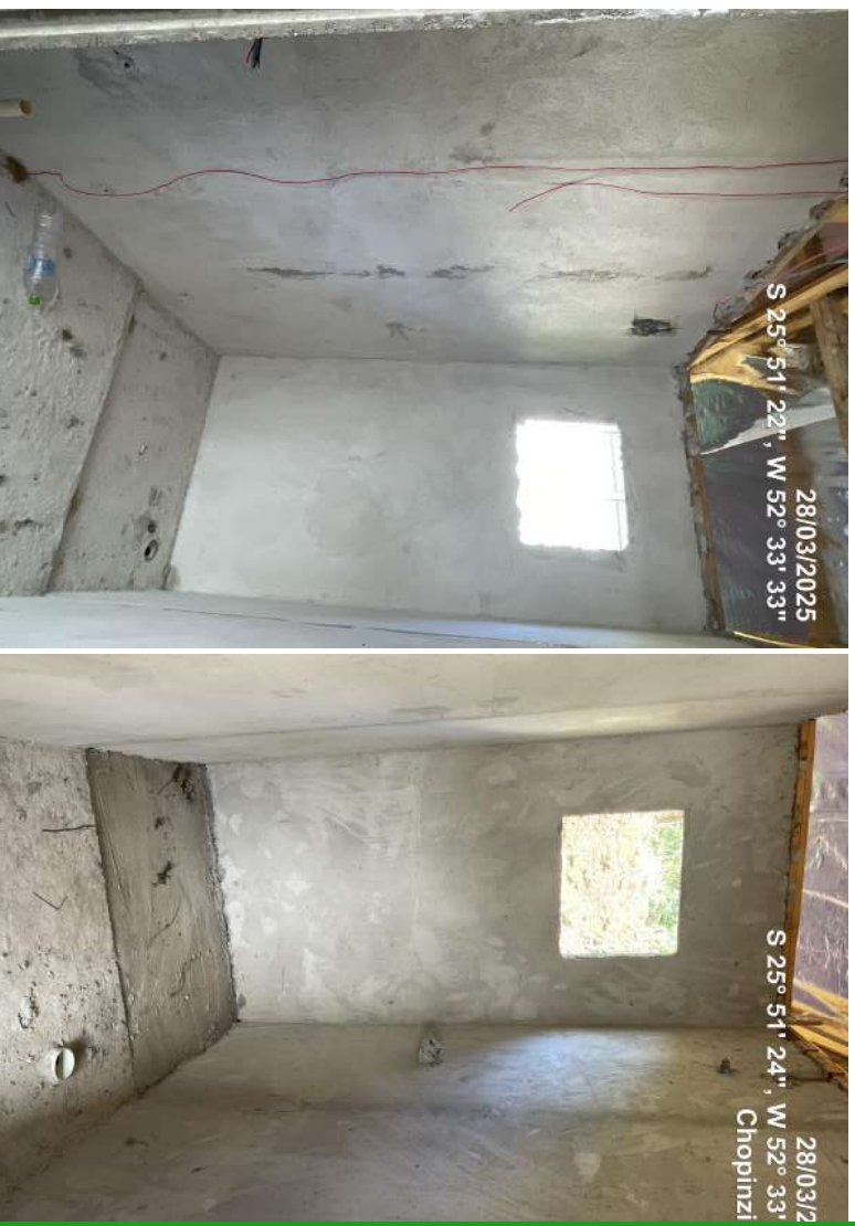
Foto 02 – Paredes do banheiro embogadas (Local 04 e 05-06)
