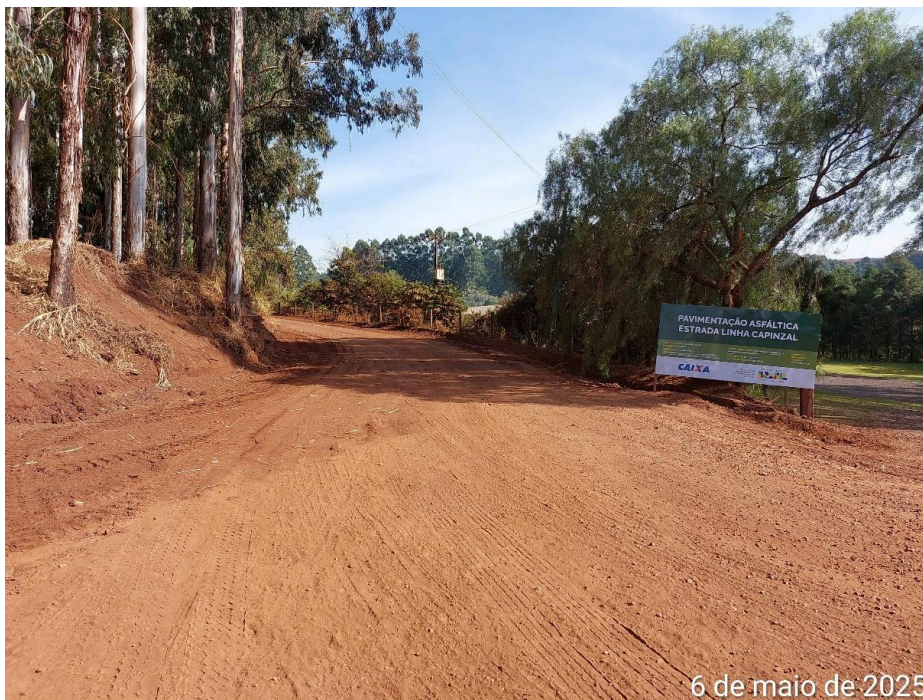
Foto 02. Placa da obra instalada próxima à estaca E1 no início da obra.
