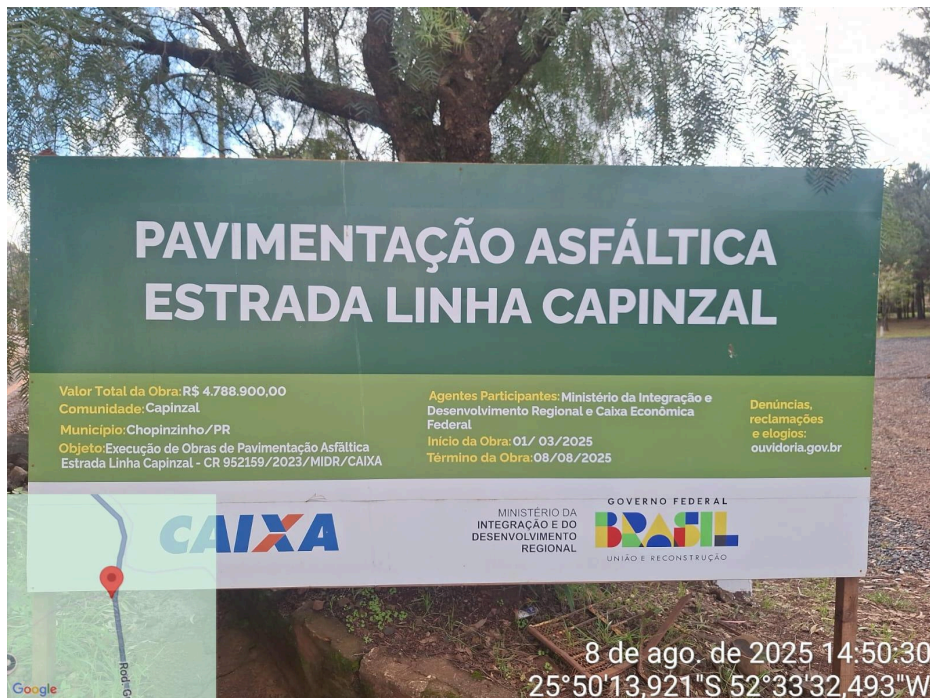
Foto 01. Placa da obra instalada próxima à estaca E1 no início da obra.
