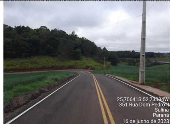
FOTO 10 Sarjeta triangular sem revestimento (Escavação mecânica em material de 1ª categoria na profundidade de até 2m) Medido: 100%
