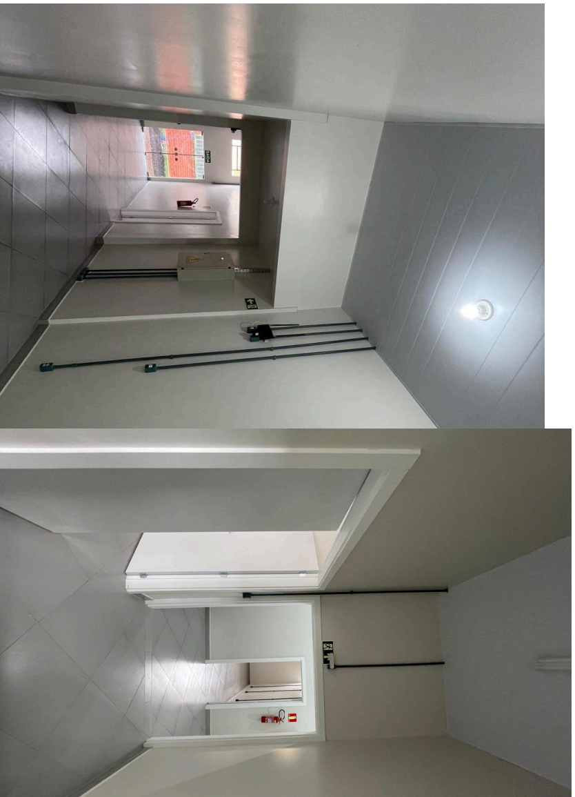
Corredor principal com internet, quadro de distribuição, tomadas, iluminação e elementos de prevenção de incêndio instalados.
