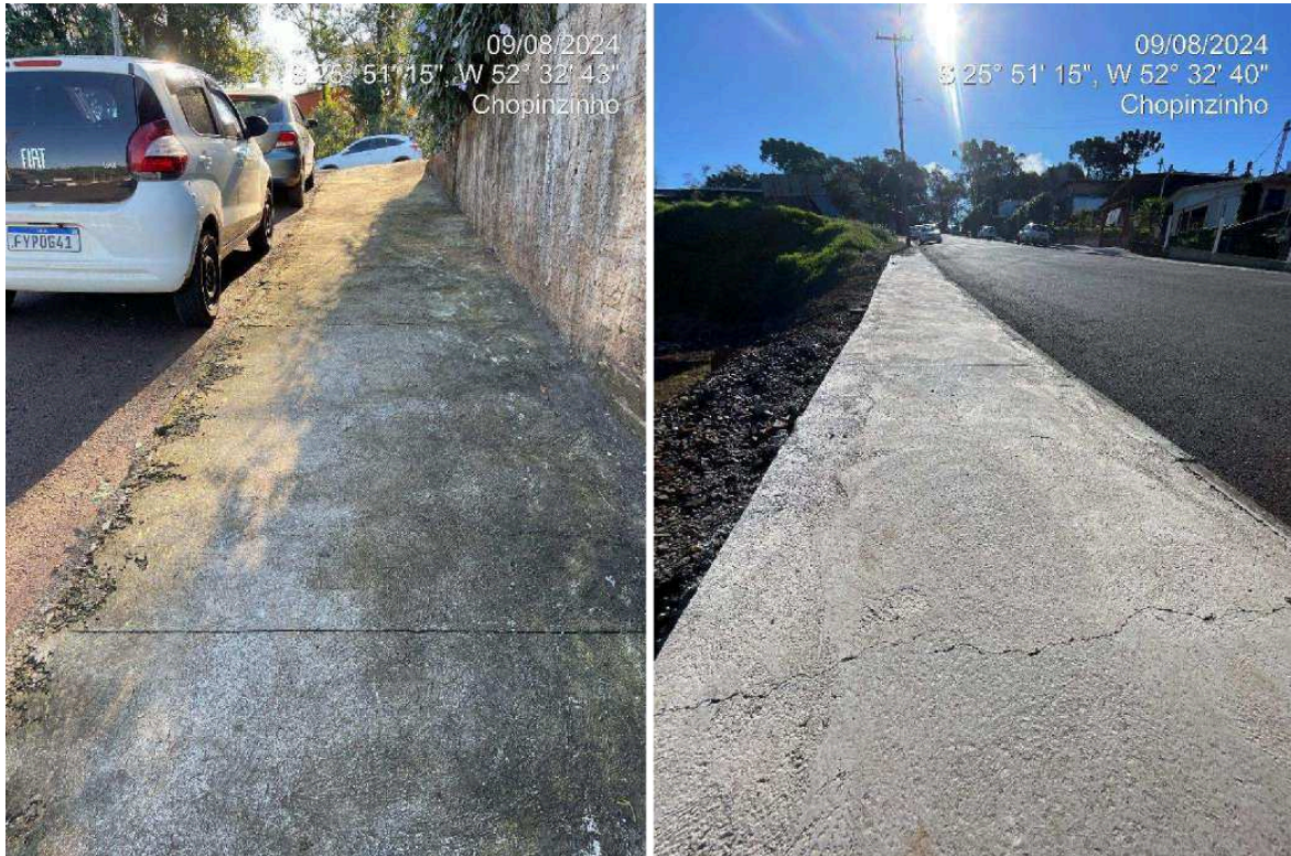
Foto 10 – Calçadas em concreto na Rua Bráulio Sauer. Baixa qualidade executiva.
