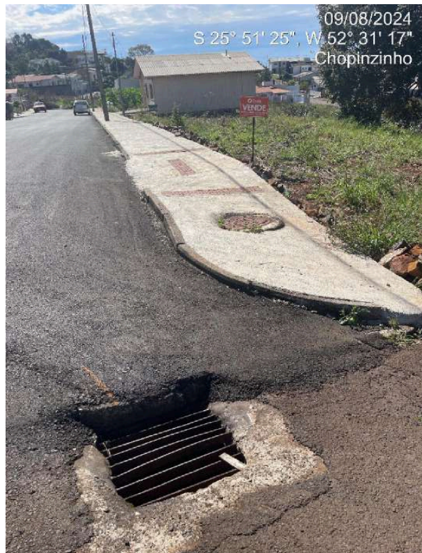
Foto 11 – Boca de Lobo a remover e relocar na Rua José Franklin de Olivera, não executado.
