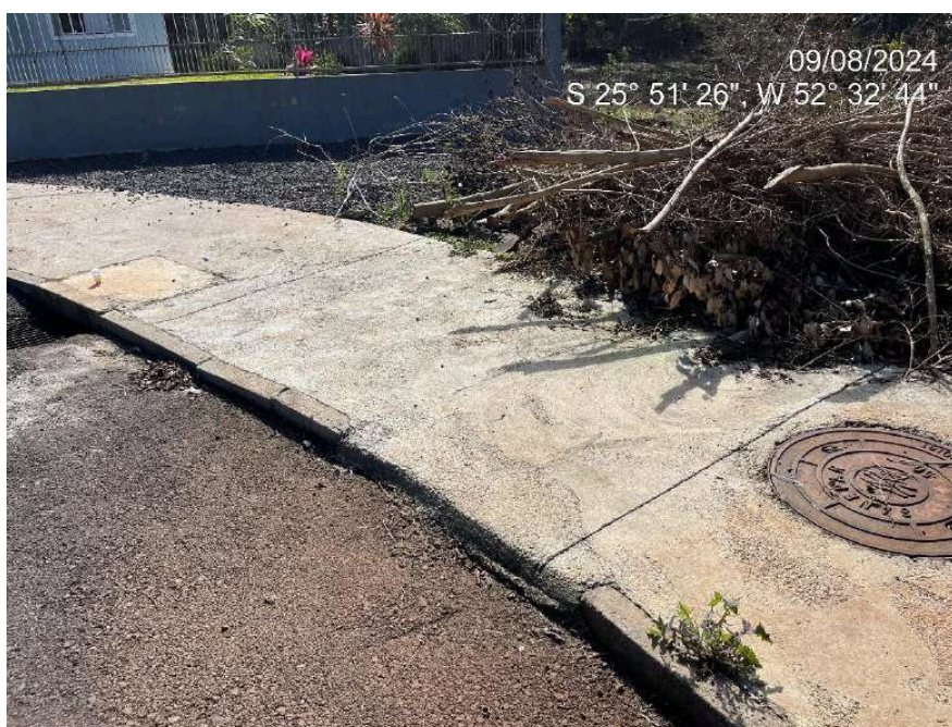
Figura 24 – Meio-fio executado com concreto da calçada; calçada com acabamento de baixa qualidade; meios-fios desalinhados.
