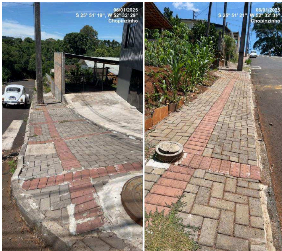
Figura 35 – Calçadas em piso intertravado na R. Brasília – Trecho 03 apresentaram baixa qualidade executiva;
