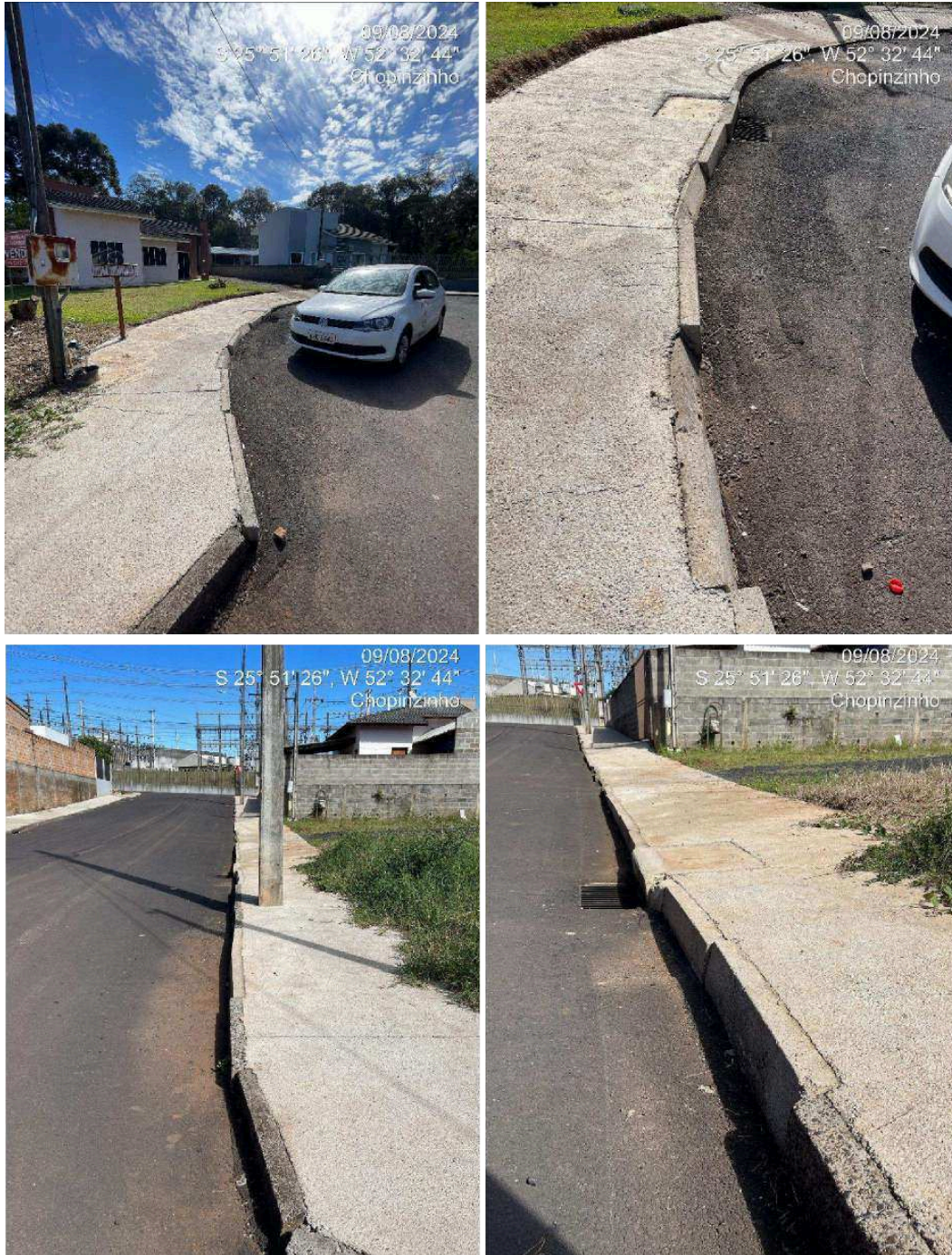
Figura 22 – Calçadas com baixa qualidade executiva, com trincas, marcas, desnível entre tampa da drenagem, frestas entre peças de meio-fio, acabamento ruim; Meio-fio de baixa qualidade e com peças de dosagem diferente não mantendo um padrão.
