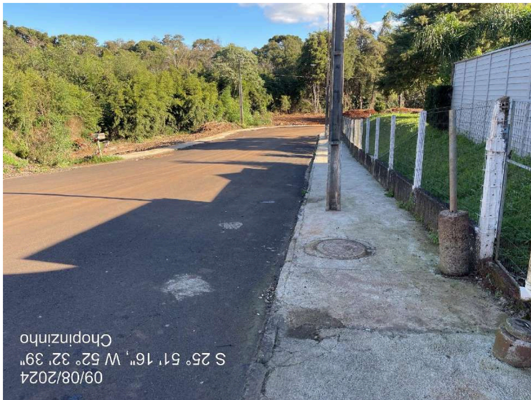
Foto 16- Calçada em concreto na Rua Armin Matte apresentando baixa qualidade executiva, trincas, ressaltos.
