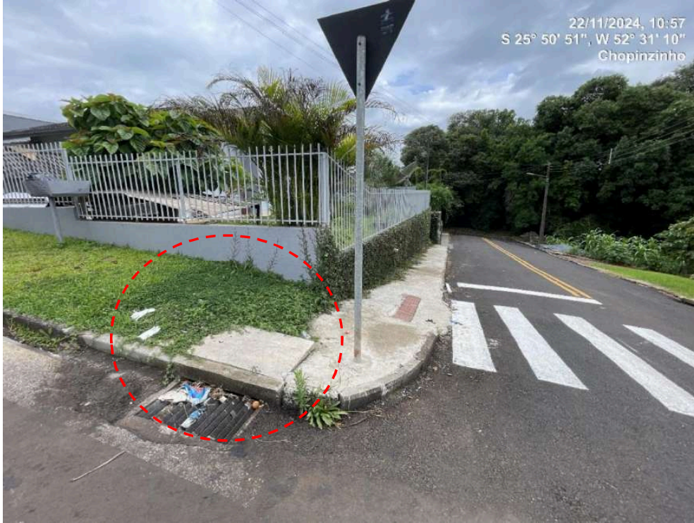
Foto 18 - Continuidade do passeio na Tva. Alferes Joaquim Ferreira, não executada.
