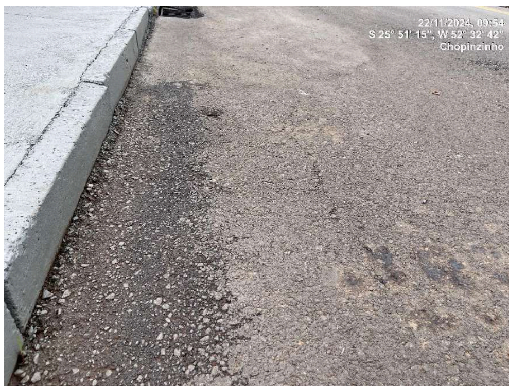
Foto 04 – Capeamento asfáltico R. Bráulio Sauer com presença de trincas, massa asfáltica porosa com agregados graúdos expostos e aparente remendo próximo a boca de lobo.
