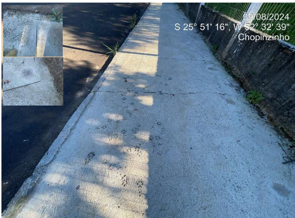
Foto 17- Calçada em concreto na Rua Armin Matte apresentando baixa qualidade executiva, trincas, ressaltos, juntas inadequadas.
