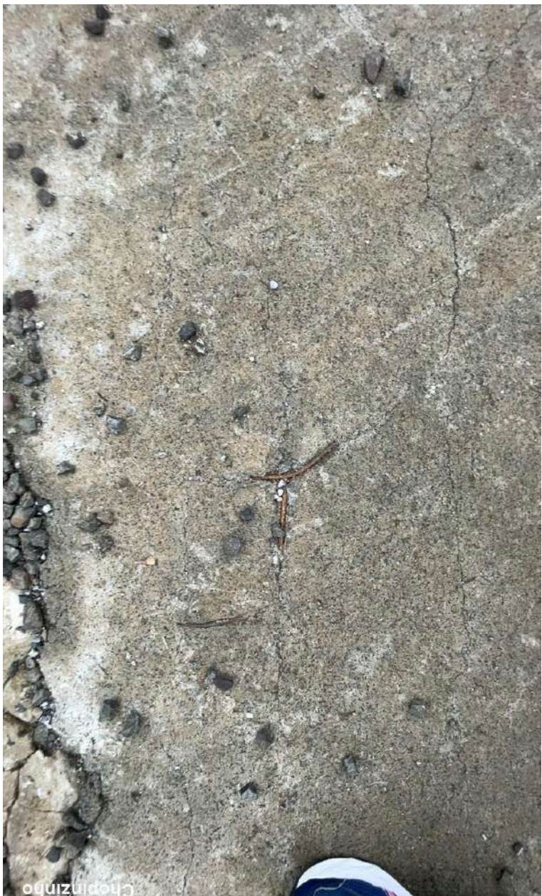
Foto 08 – Entrada de veículos com armação exposta na Rua Bráulio Sauer
