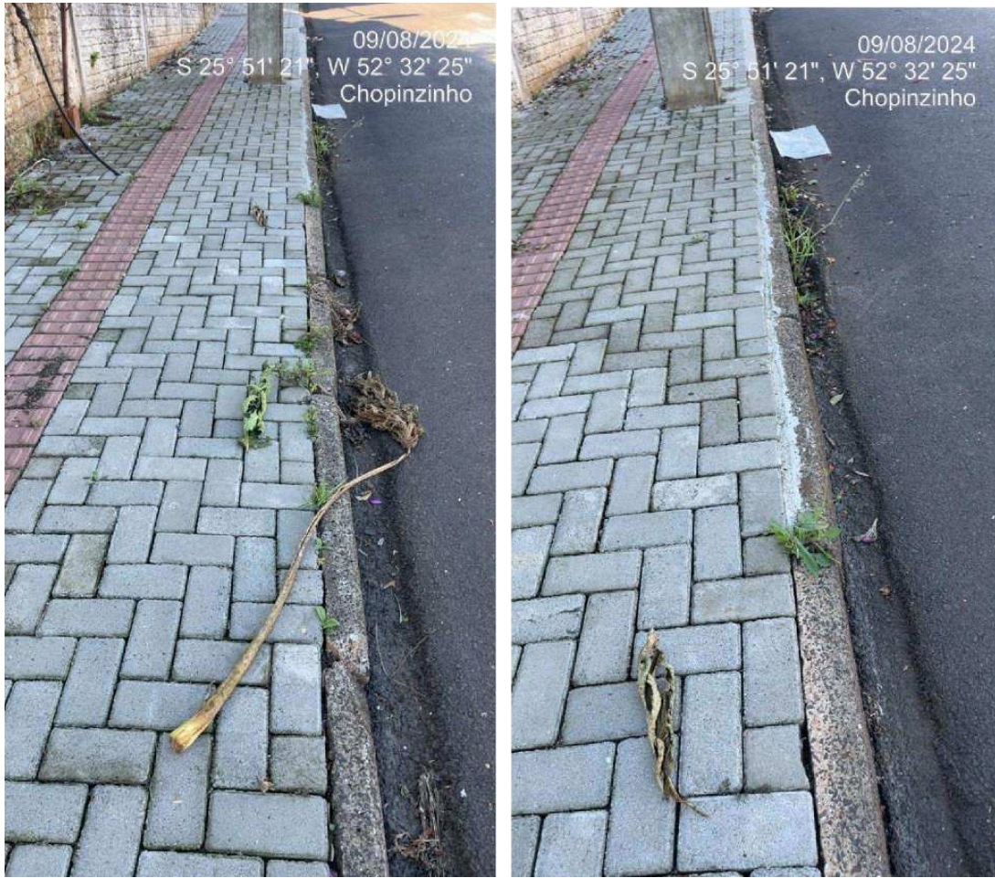
Figura 32 – Na R. São Paulo as calçadas executadas em piso intertravado apresentaram baixa qualidade executiva; (acabamento ruim, tátil com aplicação incorreta em alguns pontos, não execução de uma parte)
