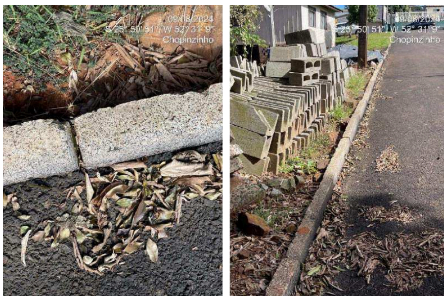
Figura 21 – Calçada de concreto que deveria ter tido meio-fio substituído. Baixa qualidade de execução.
