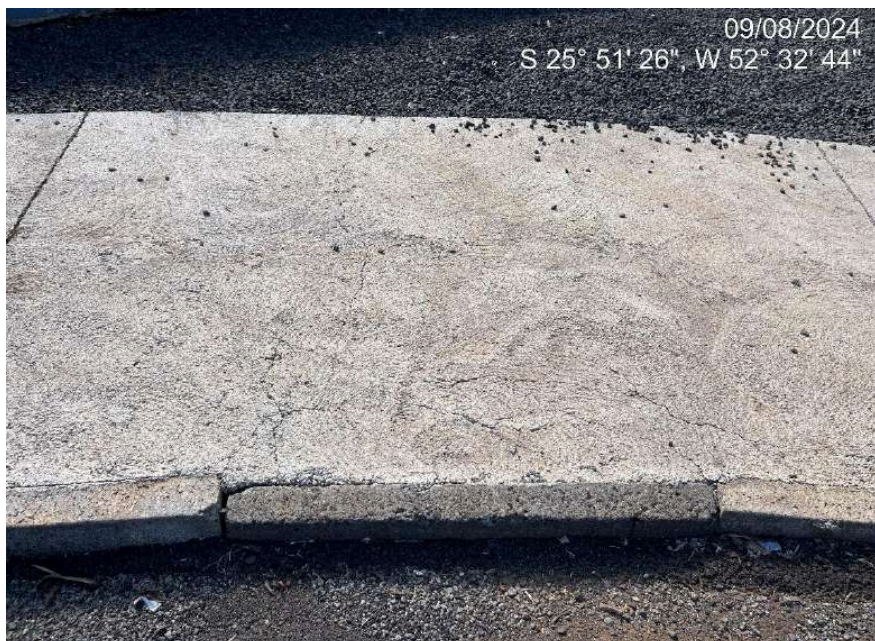
Figura 23 – Meios-fios com especificações diferentes; Calçada com trincas e acabamento de baixa qualidade;
