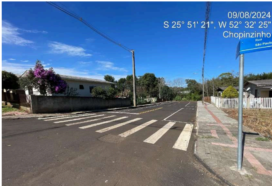
Figura 28 – Na R. Paraná não foram instalados meio-fios novos e as calçadas apresentaram baixa qualidade executiva;
