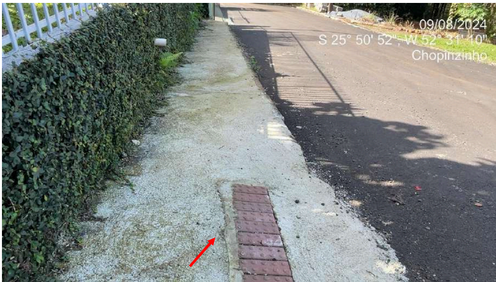
Foto 19 – Calçada em concreto na Tva. Alferes Joaquim Ferreira com baixa qualidade executiva.
