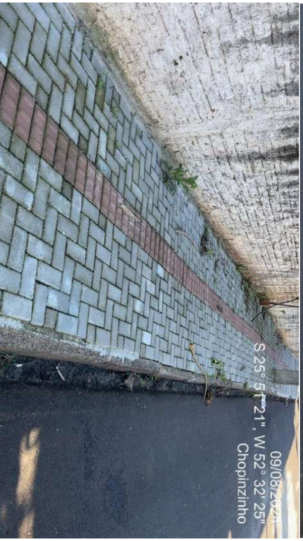
Figura 31 – Na R. São Paulo as calçadas executadas em piso intertravado apresentaram baixa qualidade executiva;
