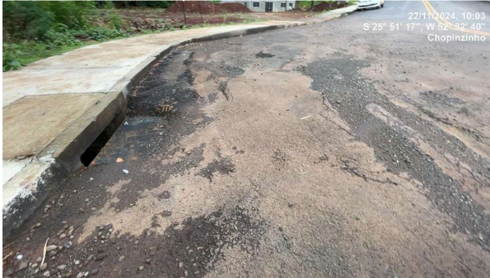
Foto 01 – Condições do pavimento ao final da Rua Prof. Bráulio Sauer. Ondulações no pavimento, falta de compactação, trincas.
