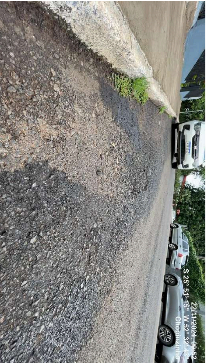
Foto 05 – Capejamento da Rua Bráulio Sauer apresentado desagregação e porosidade.
