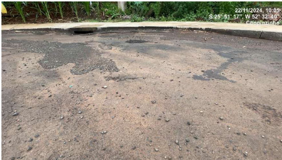
Foto 02 – Condições do pavimento ao final da Rua Prof. Bráulio Sauer. Ondulações no pavimento, falta de compactação, trincas.
