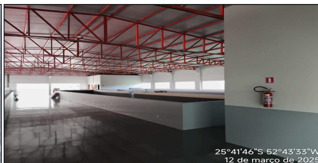
13 | 9.3 EXTINTOR DE INCÊNDIO PORTÁTIL COM CARGA DE PQS DE 12 KG, CLASSE BC - FORNECIMENTO E INSTALAÇÃO. AF_10/2020_P 9.70 PLACA DE SINALIZACAO DE
